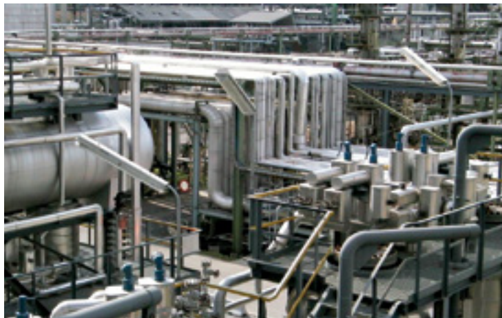
Rohrleitungen (TÜV AUSTRIA)
