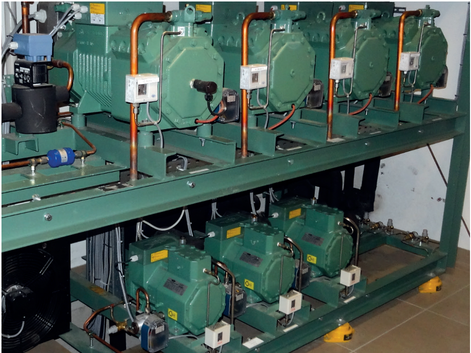
Abb. Blick auf ein Kälteverbundsystem mit Hubkolbenverdichter
