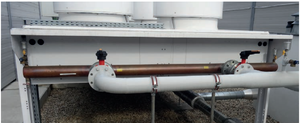
Abbildung Blick auf Rückkühleranschluss mit Luftdüsen
